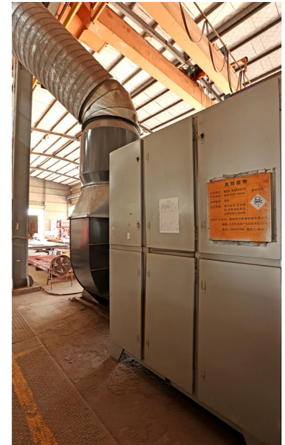
废气处理设备
